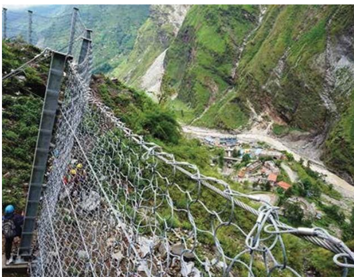
Рис. 4. Установленные защитные сети типа TSC-3000-ZD над гидроэлектростанцией
