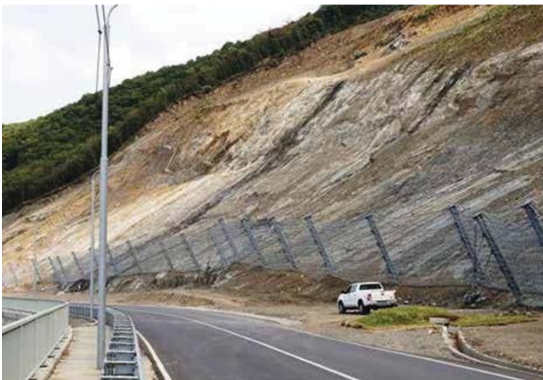
Рис. 8. Система защиты от камнепада TSC-3000-ZD (3.000 кДж) вдоль новой дороги в Тифлис
