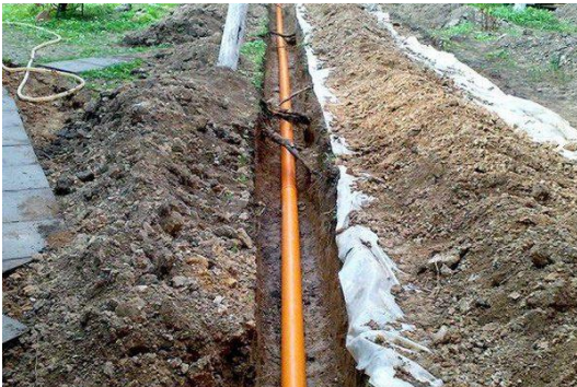
Рис. 6. Трасса канализационного сооружения может пересекать трассы других инженерных сетей, продуктопроводов, основания зданий, корни деревьев и т. д. [2]
