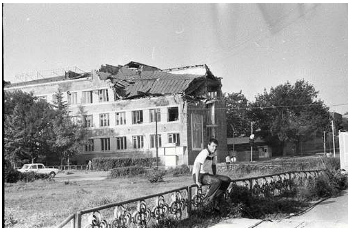
Рис. 2. Антисейсмические пояса не заведены на торцовую стену здания – и результат...
