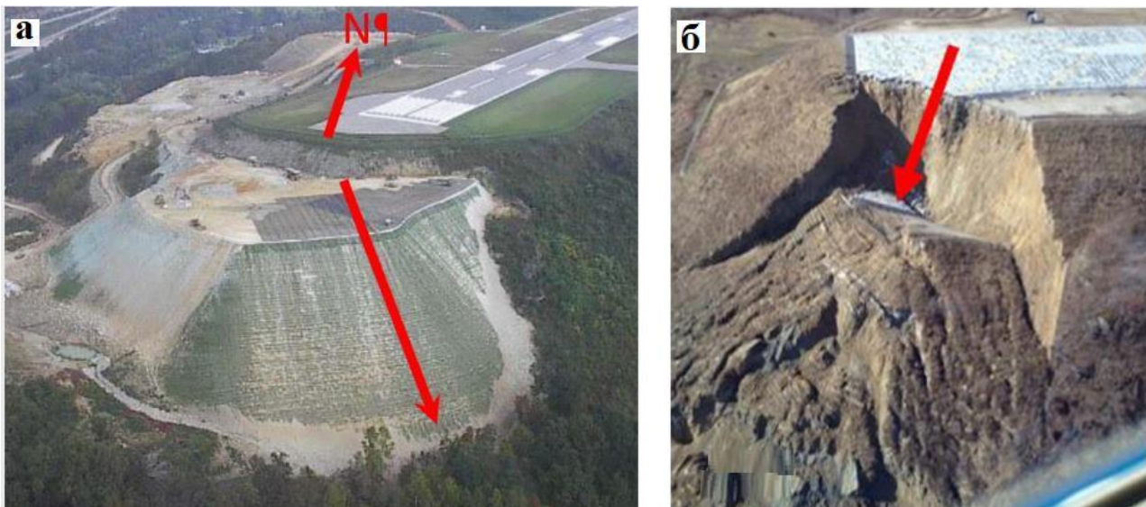
Рис. 1. Усиленный георешетками склон в конце взлетно-посадочной полосы № 5 аэропорта Иджер: а – во время строительства; б – после разрушения 12 марта 2015 года [1]
