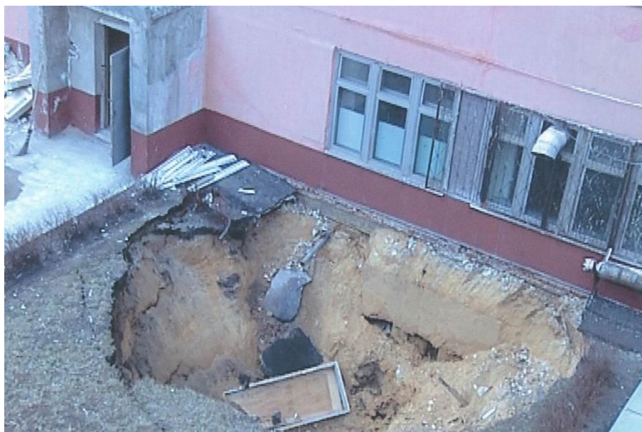
Рисунок 3 – Карстовый провал в г. Туле (произошел в 2005 г. под производственным зданием)
