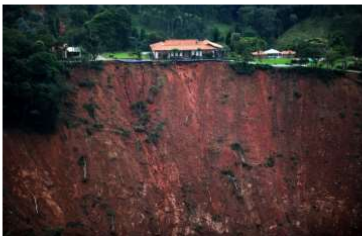
Рис. 13. Дом на краю пропасти после оползня в селении Поко Фундо недалеко от города Петрополис в январе 2011 года [3]
