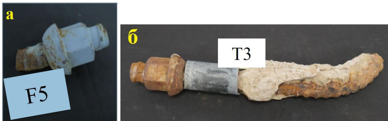
Рис. 5. Повреждения стержней анкерных болтов типов А (а) и Б (б)
