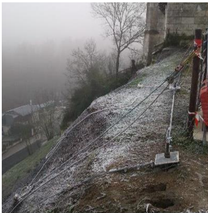
Рис. 2. Анкерные болты для закрепления верхнего несущего троса сетчатой противокаменной завесы
