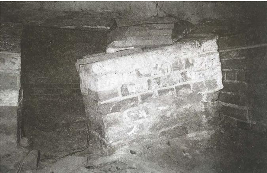
Рис. 3. Деформация фундаментного столбика Останкинского дворца в результате суффозионно-просадочных процессов в основании
