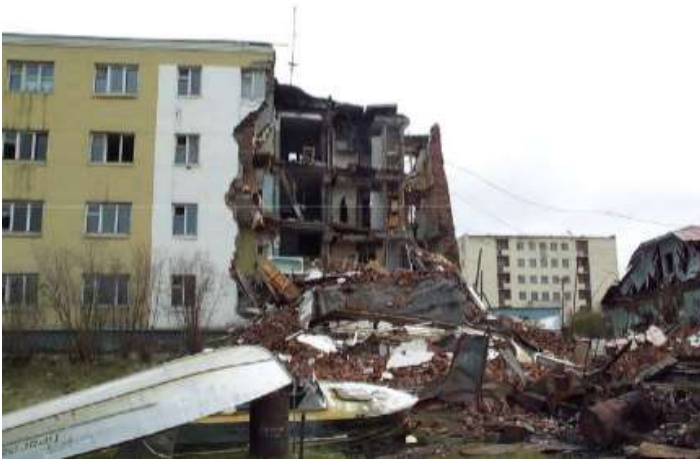
Рис. 5. Секция здания в поселке Черский, обрушившаяся в результате ослабления фундамента при растеплении его многолетнемерзлого основания [2]
